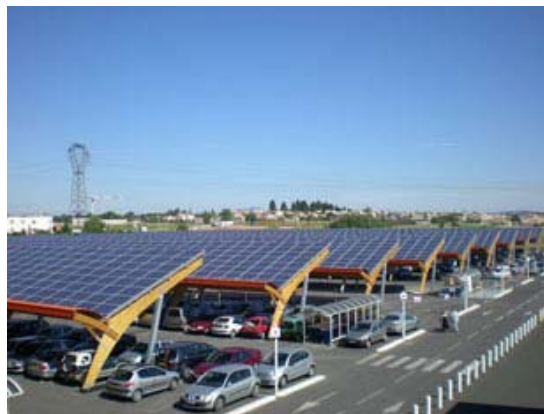
Figure 3 : parking équipé de panneaux PV en ombrière
