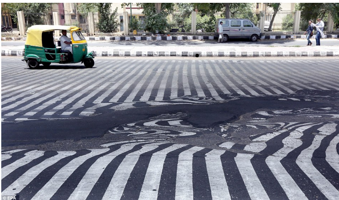
Figure 1: Déformations suite à la fonte partielle de la chaussée à Dehli en Inde en 2015. Source : The Guardian.
