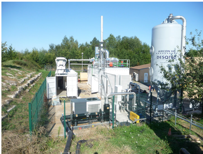
Figure 1 : centrale biogaz d'Epinay-Champlâtreux
