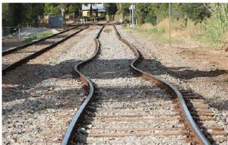
Figure 2: Déformation de rails lors de la canicule de 2003 sur la ligne de RER D
